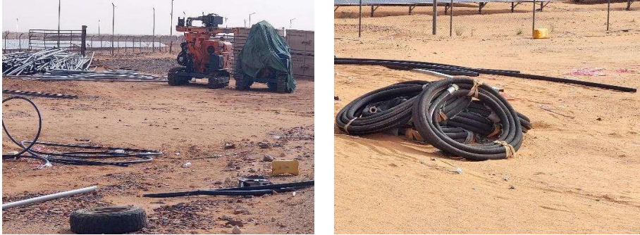
Photo 10 : Images de constats de déchets dans l'enceinte de la centrale
